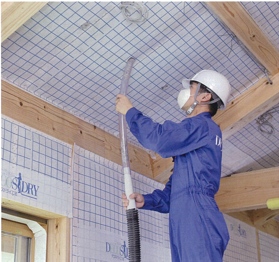
構造躯体の施工後、専用の機械で屋根や壁、床に張ったシートの内側に断熱材を吹き込んでいく。そのため、家を包み込むように隙間なく充填できる。施工はJCA 日本セルロースファイバー断熱施工協会の認定資格をもつ技術者に限定している
